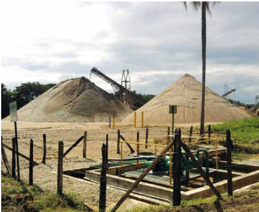
Decantador e pilha de areia ao fundo, na Unidade Porto Seguro, Registro (SP)
